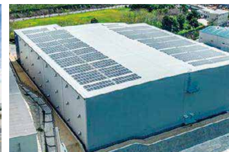
施設屋上には太陽光パネルを設置
